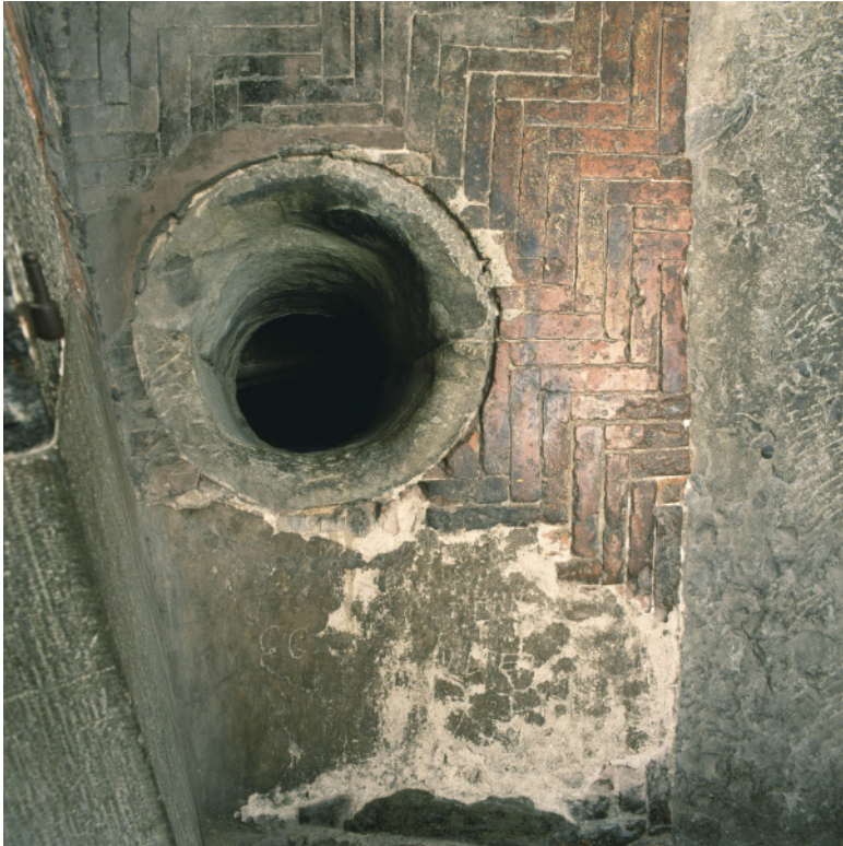
Abb. 6.7: Kuppel von Santa Maria del Fiore, Schlussring, Kappe 1 (Westen), Blick durch eine Lichtöffnung aus Macignostein in den Raum zwischen den zwei Schalen (Foto: ECHO, Rullo 12 Foto 02).
