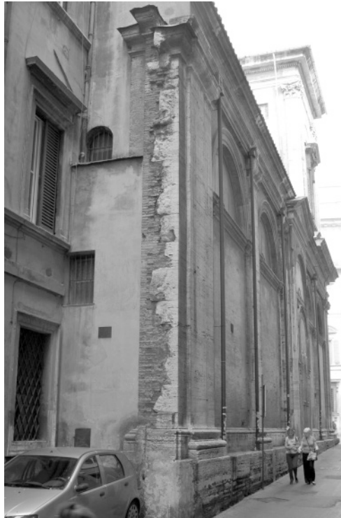
Abb. 2.62: San Luigi dei Francesi, Rom, ab 1530, unvollendete Flanke mit Verzahnung zwischen Ziegelsteinmauer und Travertinfassade (Foto: H. Schlimme).
