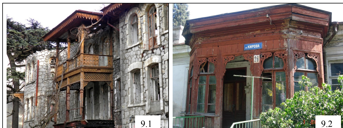
Рис. 9. Аварийные старинные здания на территории г. Ялта
